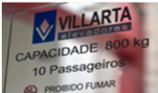
Figura 6 – Placa de sinalização de capacidade
